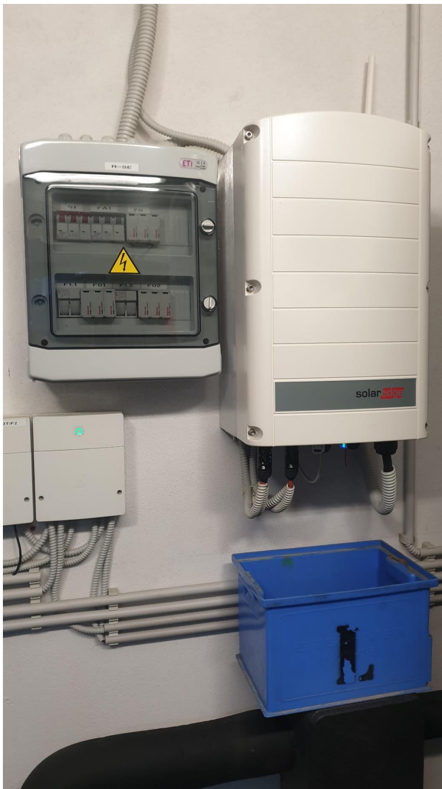
INVERTER OD ELEKTRARNE
