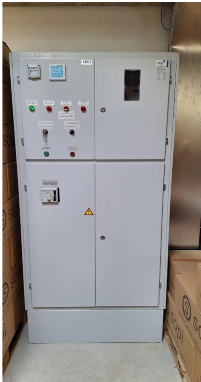
AC omara in ločilno merilno mesto v I. nadstropju objekta
