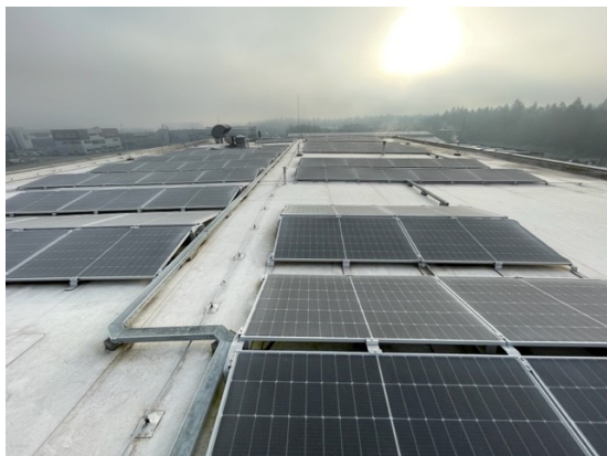
Slika: Območje PV modulov – streha objekta A
