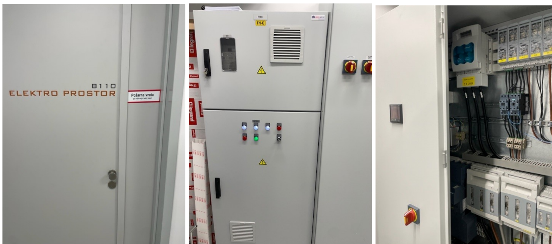
Slika: objekt B 1. nadstroje Elektro prostor – omarica PMO
