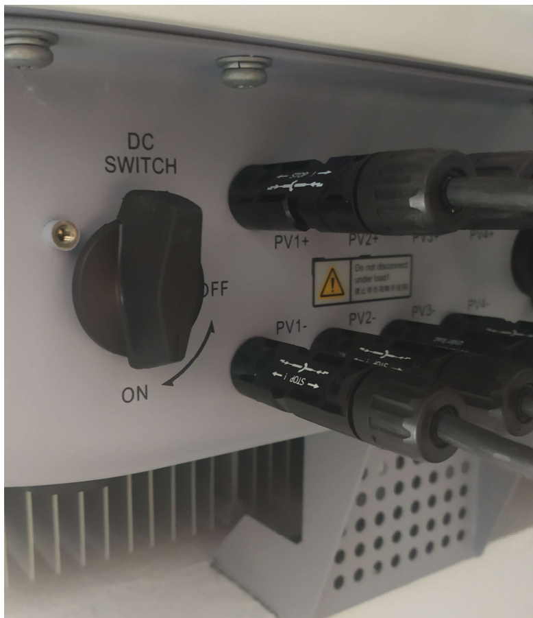
Slika 9: Razsmernik na levi strani s slike 7- Stikalo za IZKLOP RAZMERNIKOV NA SPODNJI STRANI RAZSMERNIKAV - ČRNO STIKALO v 2. nadstropju
