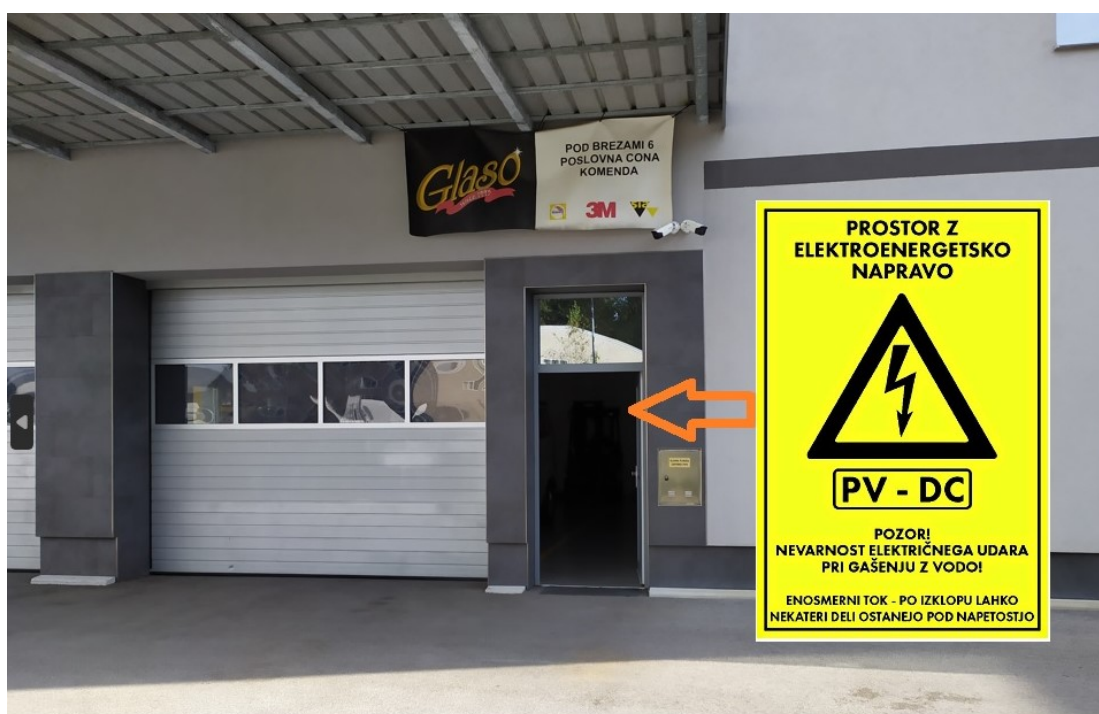
SLIKA 13: slika lokacija Elektro omare za elektrarno se nahaja v pritličju prostora
